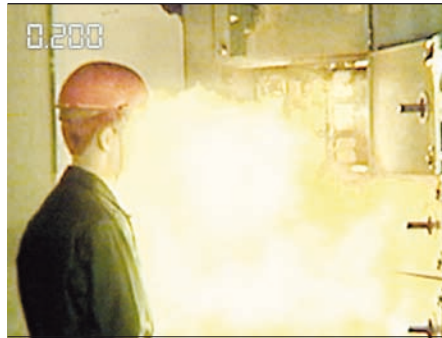
1a Accidente por arco sin protección
